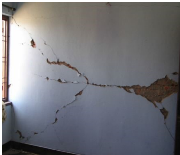
(d) Diagonal and shear crack
